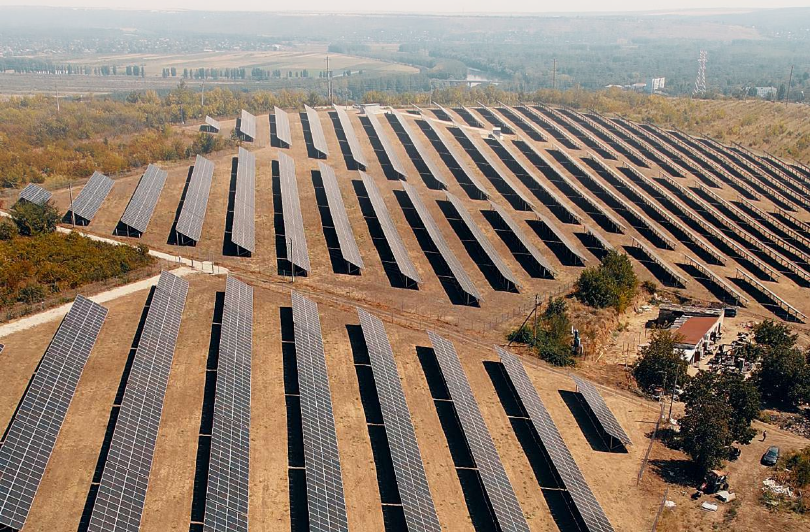
Parc solar al Premier Energy, lângă Chișinău, Republica Moldova
